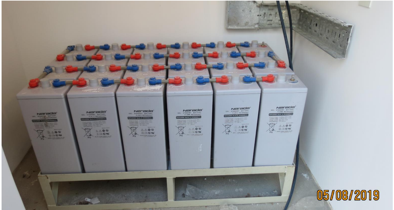
Figura 2.c.5 – Puesto Arteaga – Banco de baterías control de tensiones.
