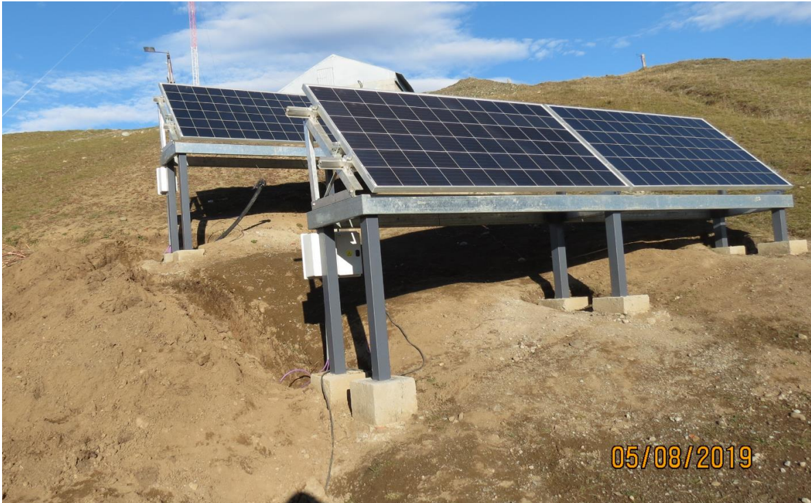
Figura 2.b.2 – Puesto El Zurdo – Paneles Fotovoltaicos
