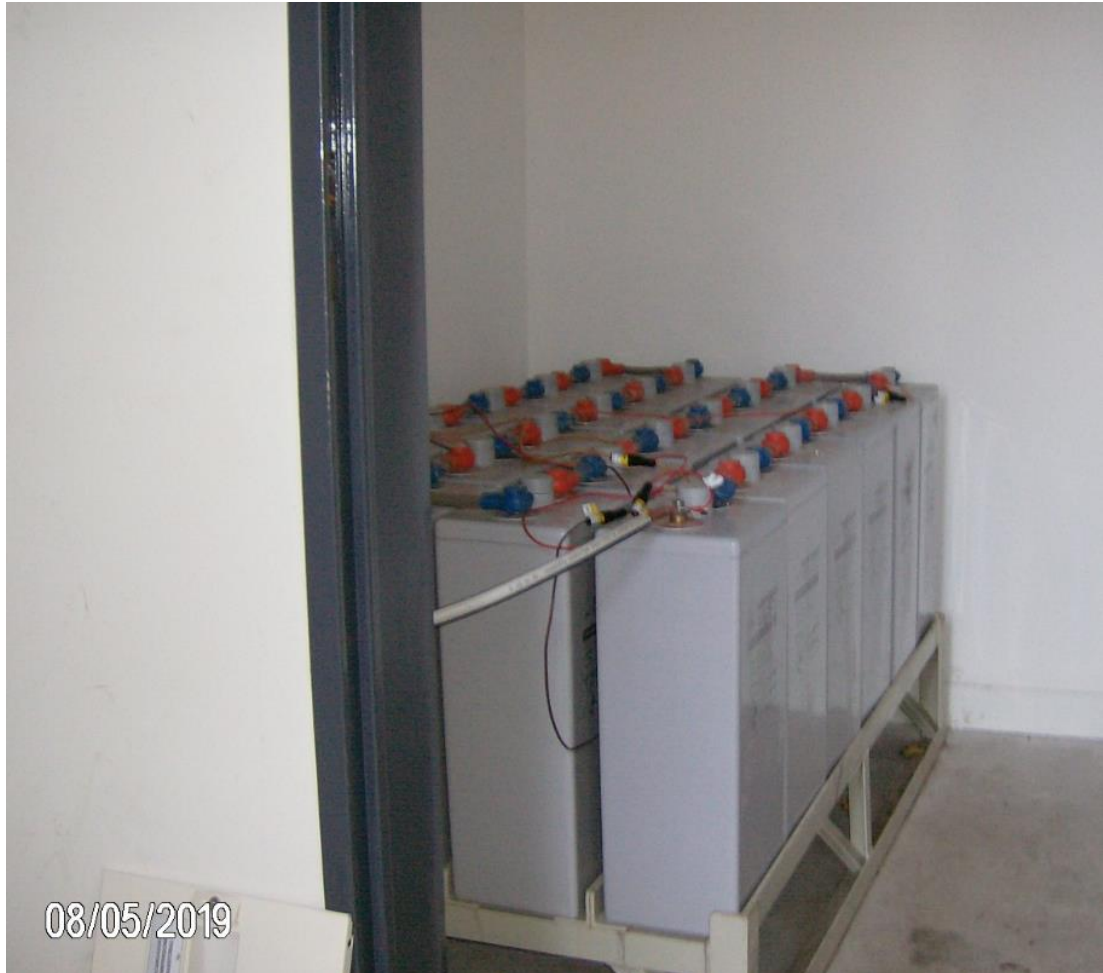
Figura 2.b.4 – Puesto El Zurdo – Sala de baterías próxima al TGBT
