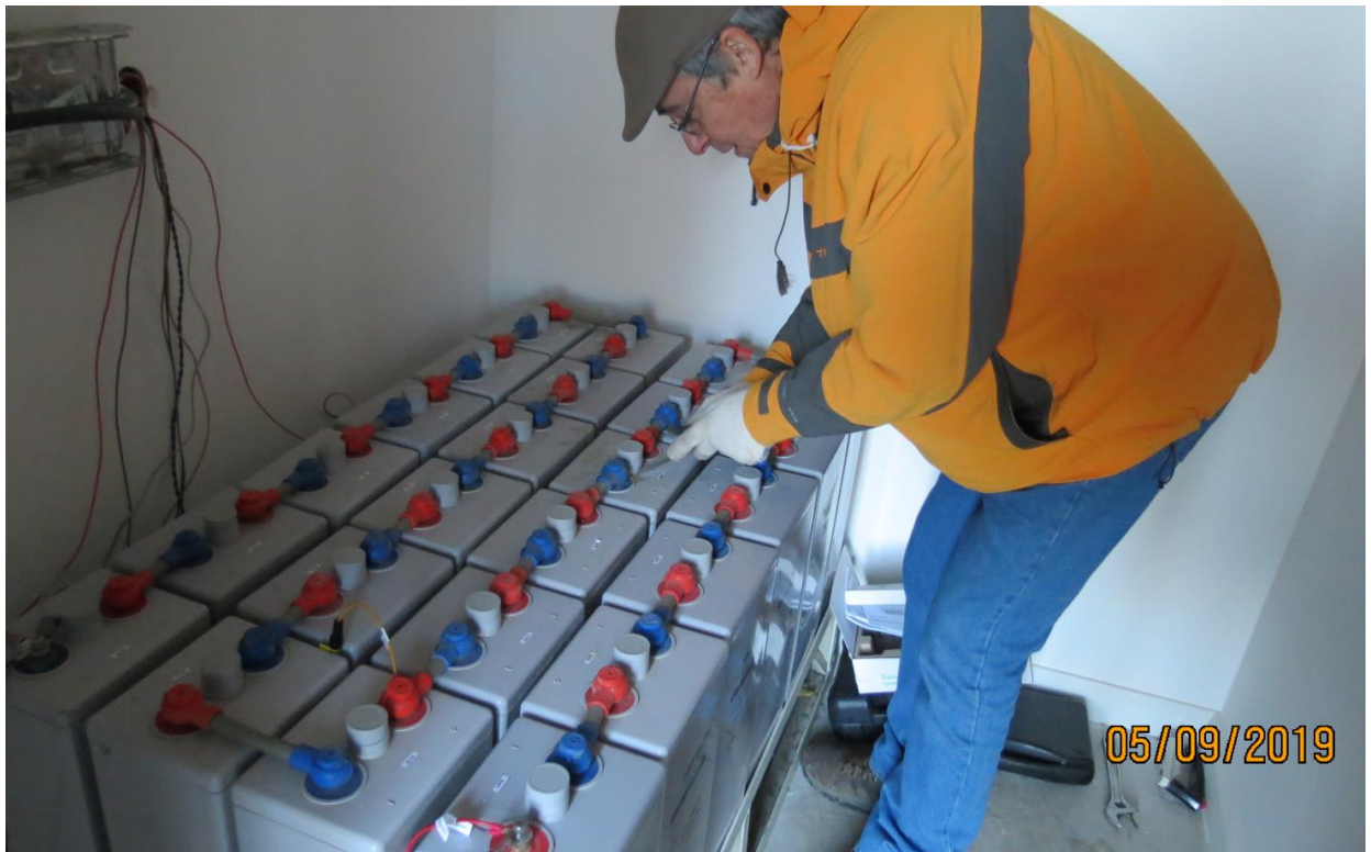
Figura 2.b.14 – Puesto El Zurdo – Banco de baterías revisión Ing. Albornoz
