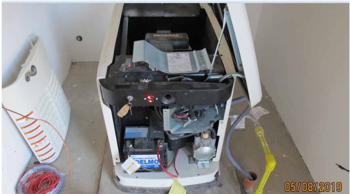
Figura 2.b.5 – Puesto El Zurdo – Diesel a propano Generac
