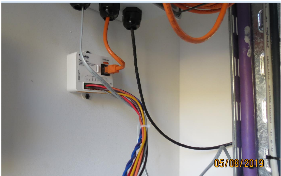
Figura 2.b.11 – Puesto El Zurdo – Circuito asociado al Battery Monitor y shunt de corriente
