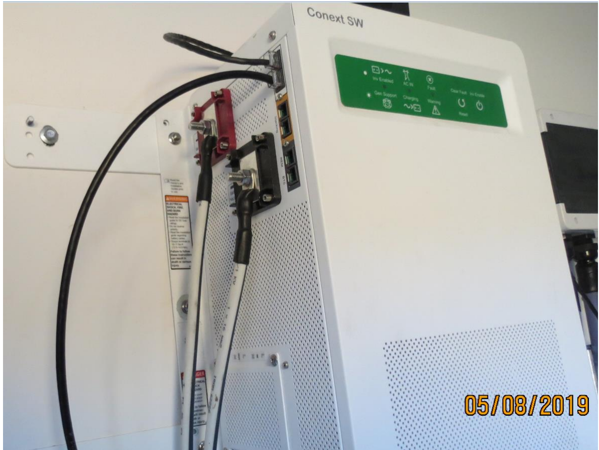
Figura 2.b.10 – Puesto El Zurdo – Conexión inicial Inverter SW4048
