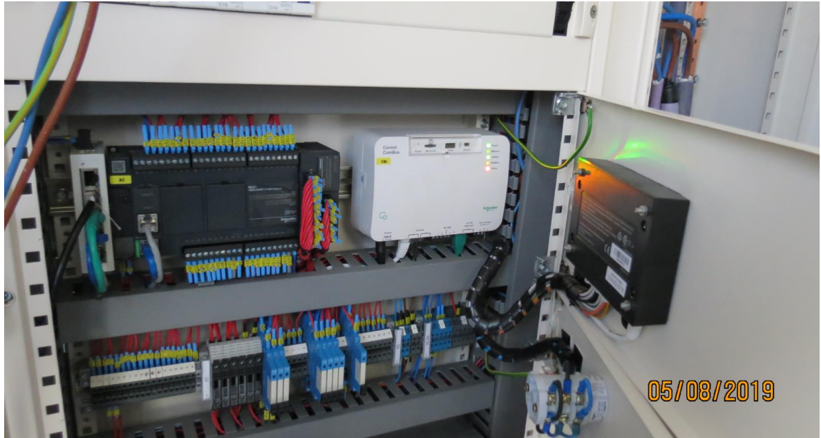
Figura 2.b.12 – Puesto El Zurdo – Combox y PLC en TGBT
