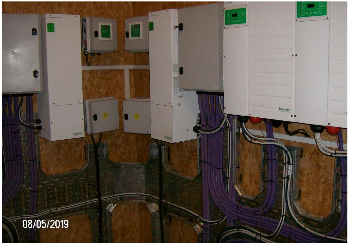
Figura 2.a.6 – Verificación de cableados previos a conexión en Inversores y reguladores en Casco Morro, día 8/5/19
