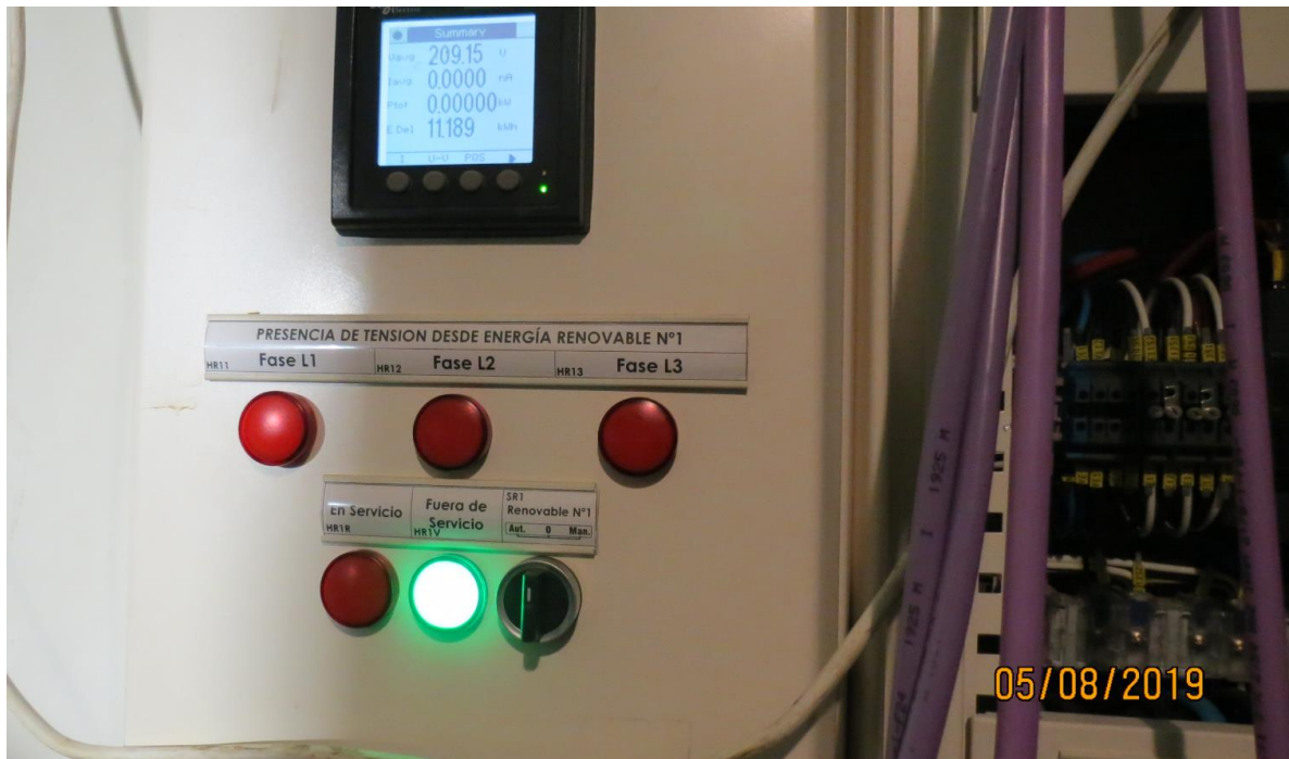
Figura 2.a.11 – TGBT con ingreso de tensión de grupo diésel Deutz el 8/5/2019
