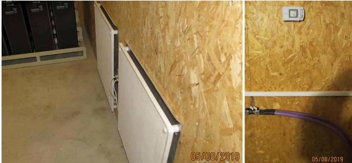
Figura 2.a.4 – Calefactores para sostenimiento de temperatura mínima de operación en recinto banco, con conexión antiexplosiva, conectados al monitor de temperatura interno – Casco Morro Chico
