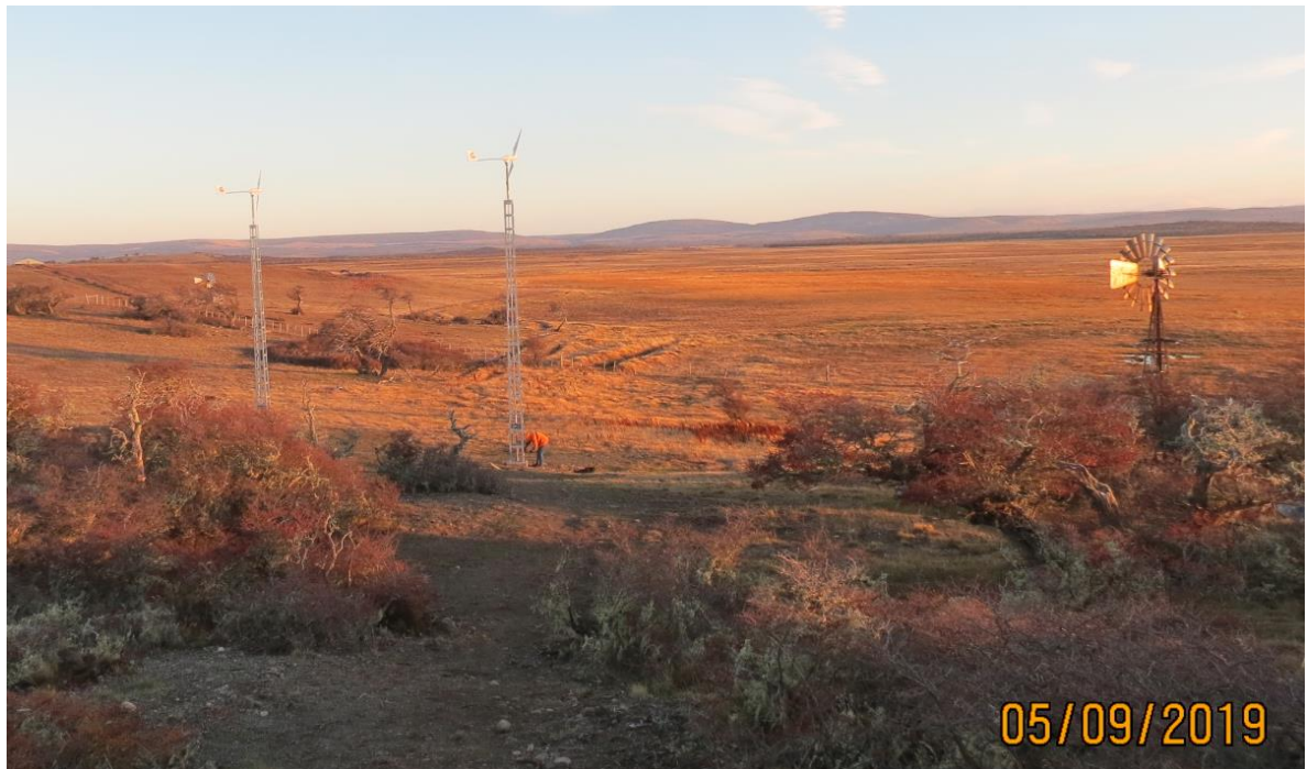
Figura 2.a.17 – Vista de ambos generadores Bornay instalados en casco
