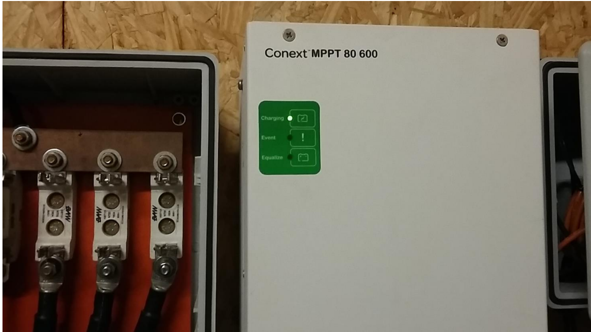
Figura 2.a.8 – Encendido en secuencia a 48Vcc de reguladores solares Conext MPPT en Casco Morro, 8/5/19
