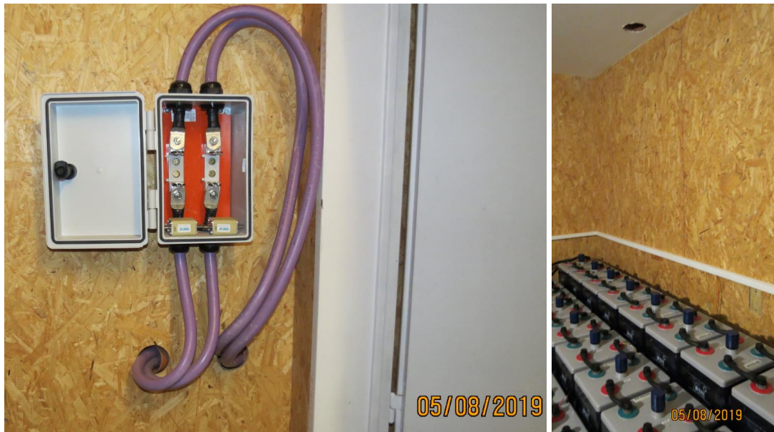
Figura 2.a.5 – Fusibles de protección en uno de los bancos en recinto aislado y ventilación preliminar para disipar salida de hidrógeno durante proceso de carga rápida – Casco Morro Chico
