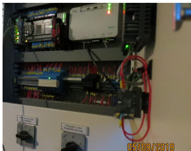
Figura 2.a.21 – PLC (izq) y Combox #1 (der) de Schneider para acceso al sistema en casco Morro Chico
