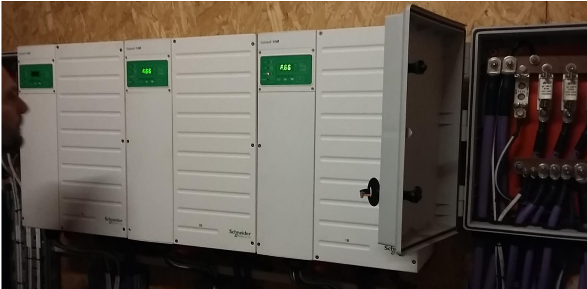
Figura 2.a.10 – Encendido a 48Vcc en secuencia de Inversores XW Schneider en Casco Morro, 8/5/19
