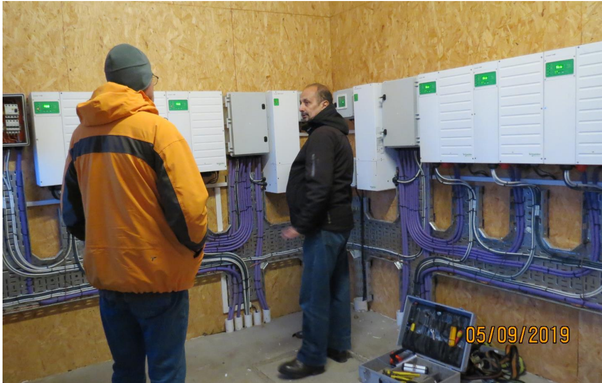
Figura 2.a.16 – Ings. Albornoz y D'Aloia en verificación con sistemas operando, previo a la configuración de los sistemas vía Xanbus
