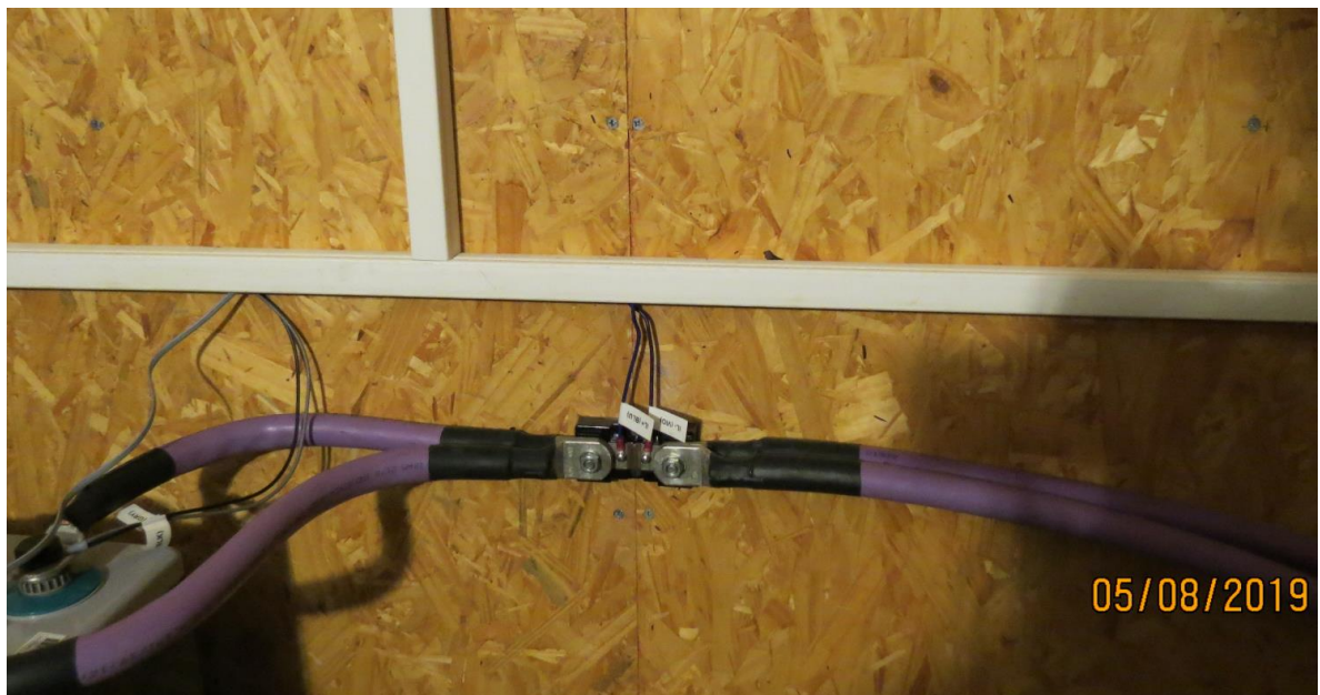
Figura 2.a.3 – Uno de los dos shunts de medición de corriente para Battery Monitor de los Bancos de baterías BAE en Casco
