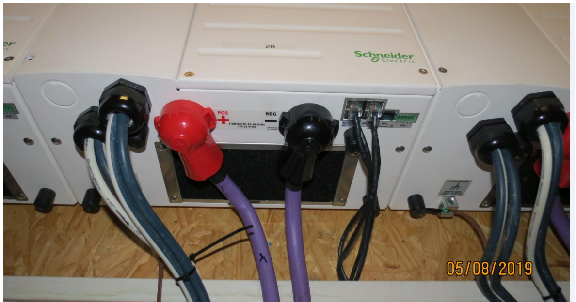
Figura 2.a.7 – Verificación de cableados de alterna, baterías y comunicaciones Xanbus en Inversores XW
