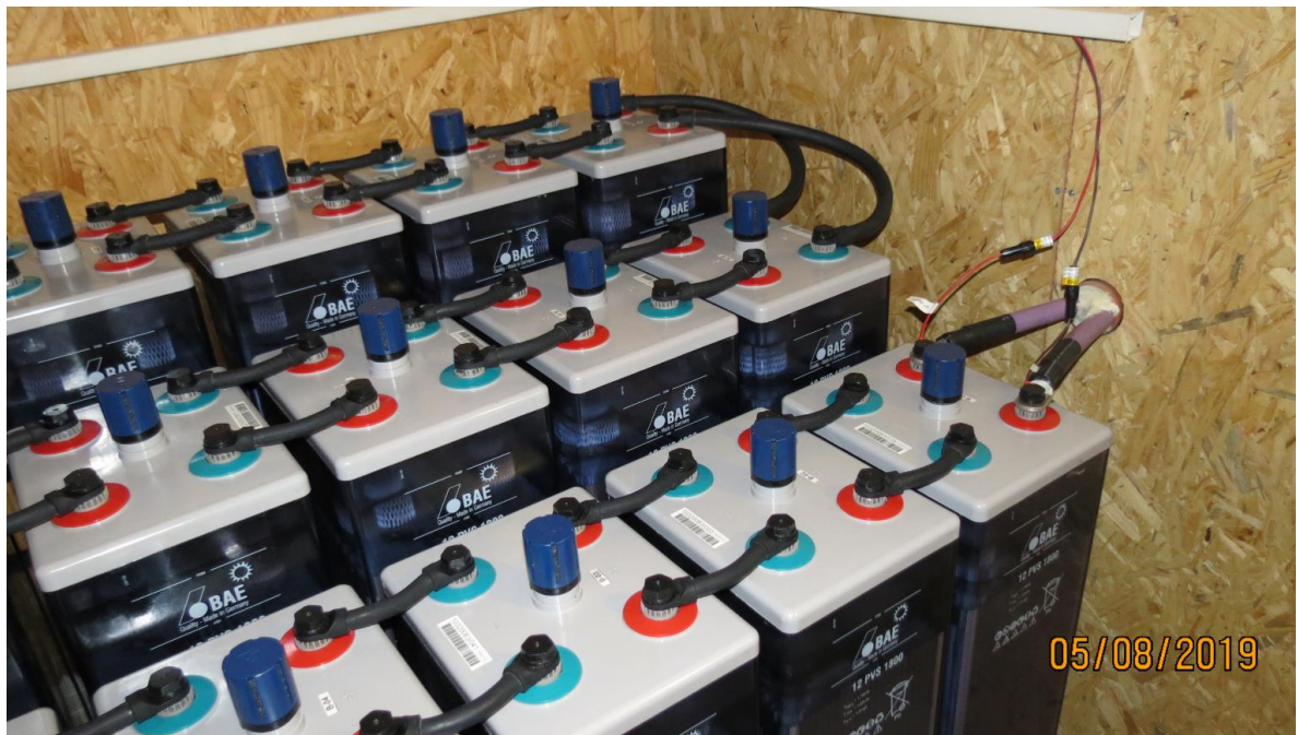
Figura 2.a.2 –Banco de baterías #2 BAE de 48V, 1500Ah con cableado listo para conexión 8/5/19, en Casco Morro Chico
